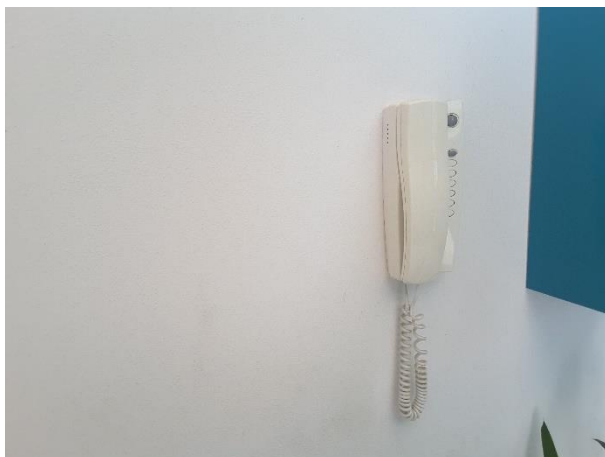
Impianto citofonico con apparecchio apriporta elettronico
