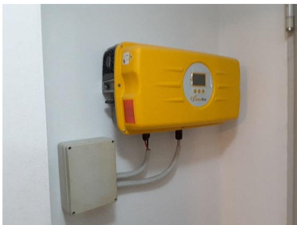
Impianto fotovoltaico a tetto, alla data del sopralluogo non collegato e non funzionante
